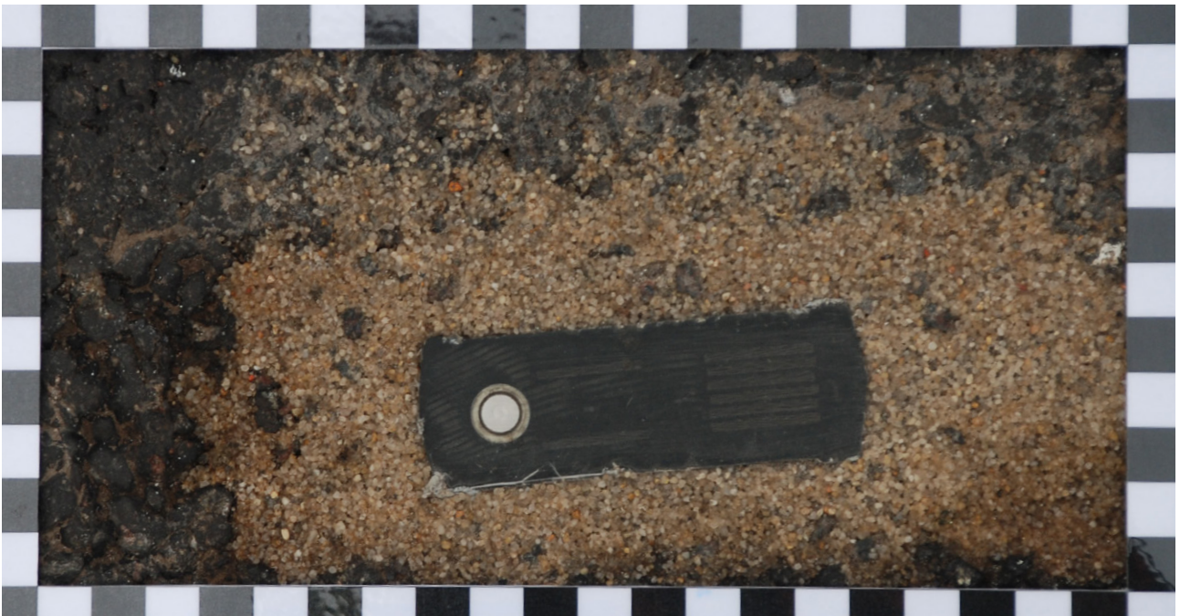
Figur 4.7: Temperaturføler monteret i DA 8-belægningen. Selve føleren kan ses i figur 5.2.
