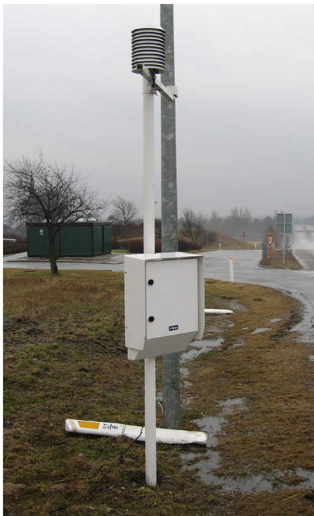
Figur 5.4: Den eksisterende vejstation på motorvejen. VAISALA-sensorer er monteret i motorvejens kørebaner til højre for vejstationen.
