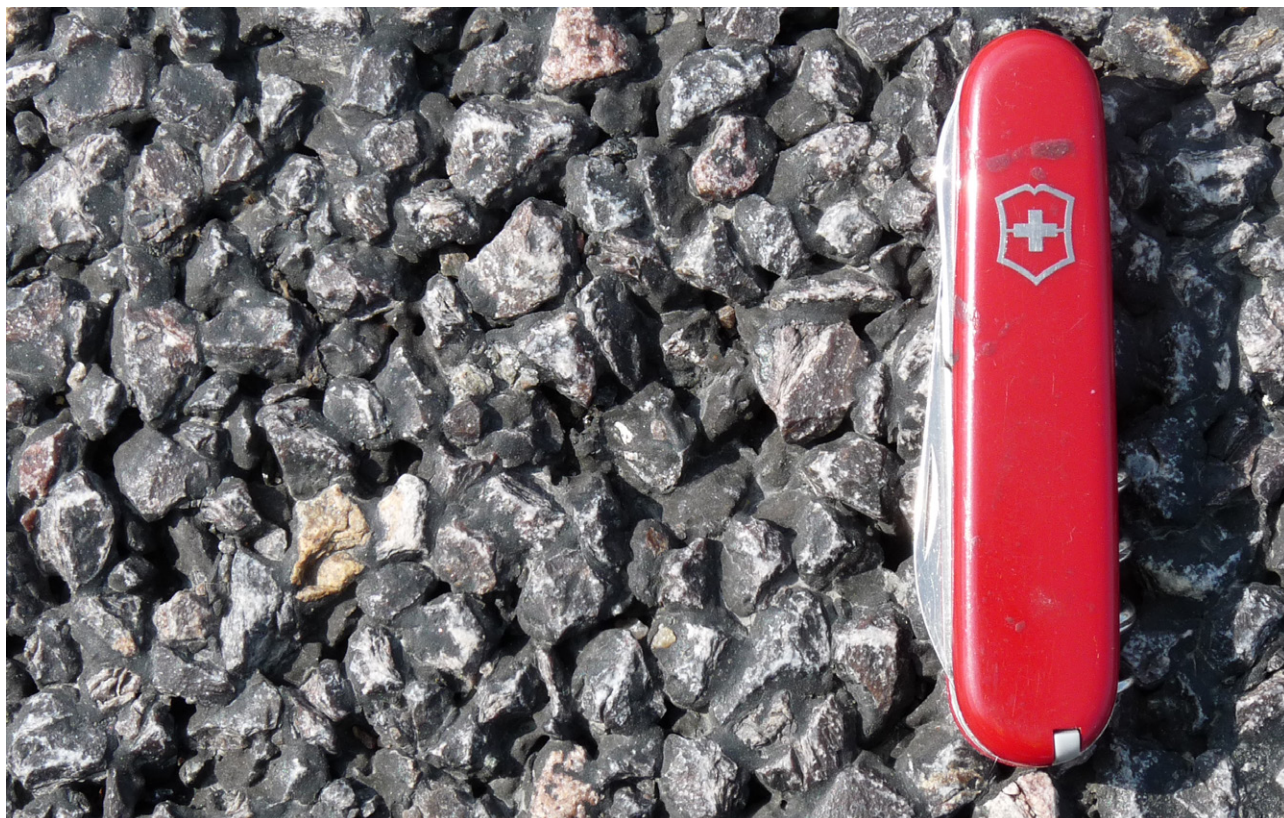
Figur 3.2: Close up-foto af to-lags drænasfalt med 11 og 16 mm sten i henholdsvis øverste og nederste lag på Motorvej E4 ved Husqvarna da belægningen var to år gammel i maj 2012.
